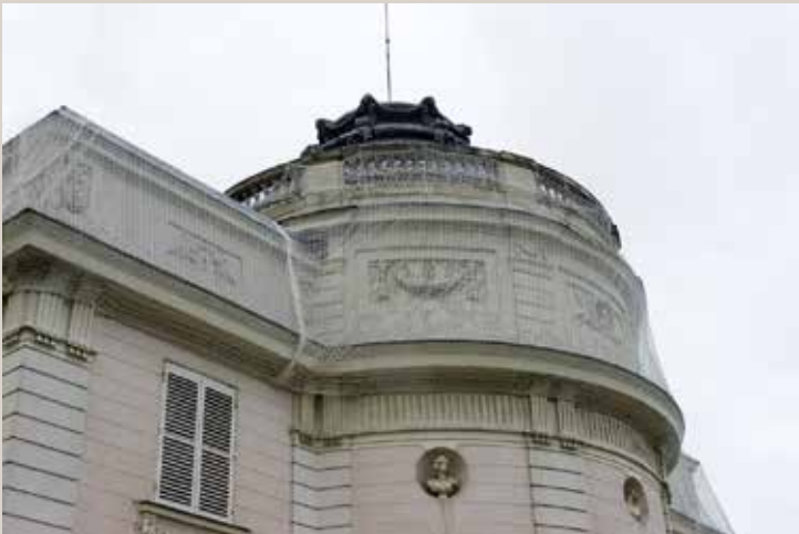
Vue des dégradations sur la façade du château.
