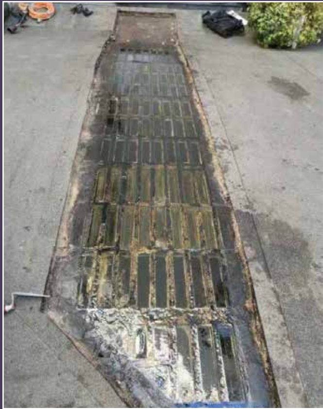
Sondage dans l'étanchéité de la coupole de verre, 2022 (© Archibuilt).
