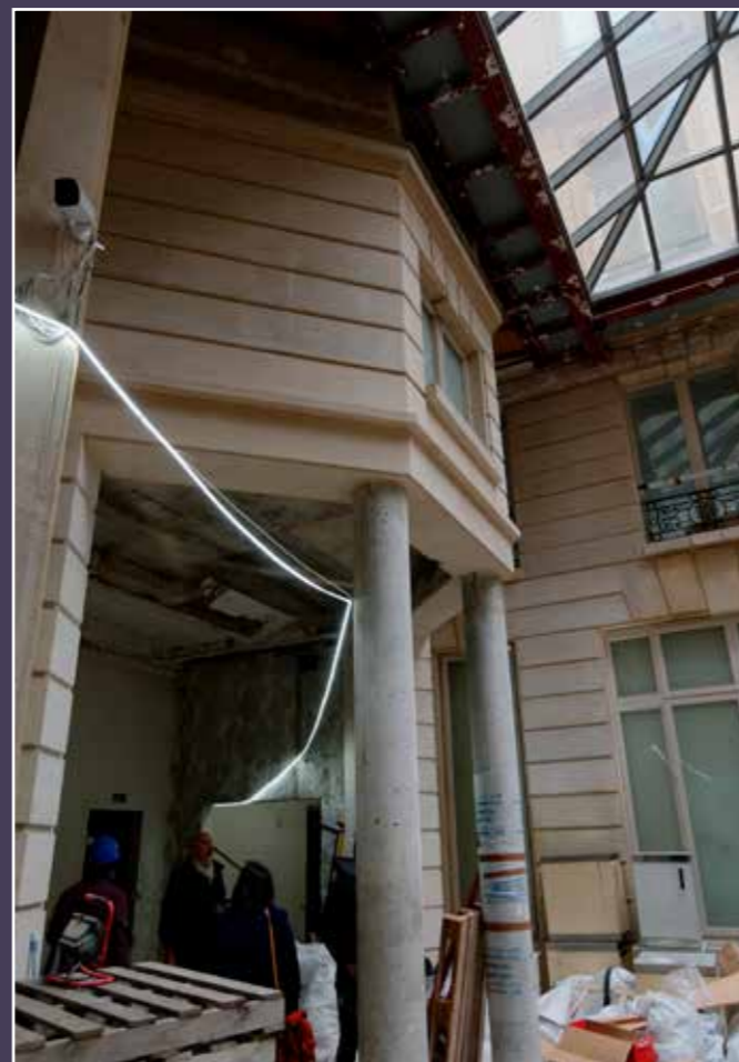
Vue actuelle du rez-de-chaussée de la cage d'escalier au 14, rue Halévy, avec verrière au R+1 sur une partie de la cour A.
