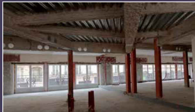
Vue actuelle du plateau au R+1 vers la pointe Nord de l'îlot, suite à curage.
