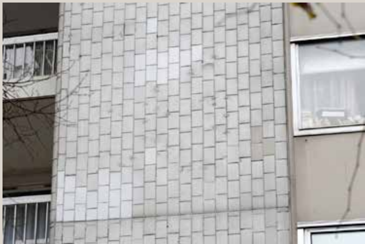
Détail du revêtement céramique. Les zones plus claires sont celles déjà réparées.
