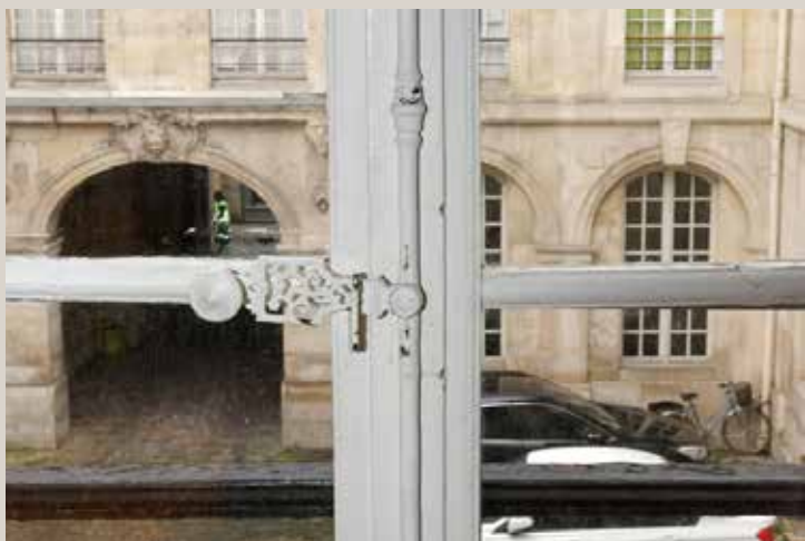
Détail d'une croisée du XVIII e siècle (anciennement à petits bois). Toutes les menuiseries sont appelées à être remplacées.
